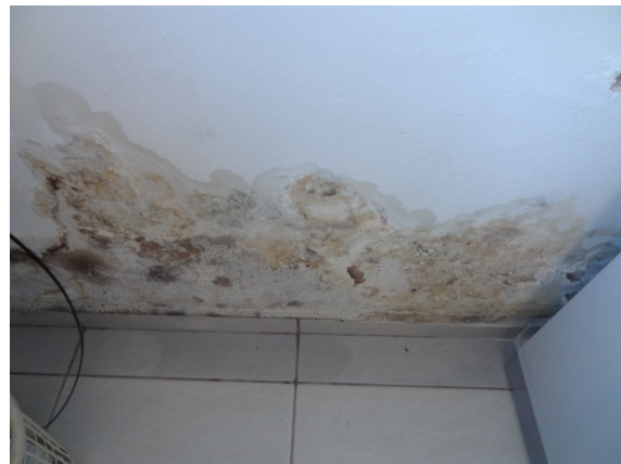
Foto 2 – Infiltração no Distrito.
