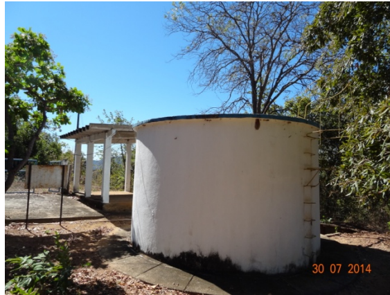
Foto 1 – Res. ausência de guarda-corpo
