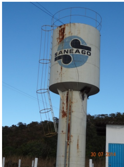
Foto 3 – Reservatório com corrosão e pintura desgastada
