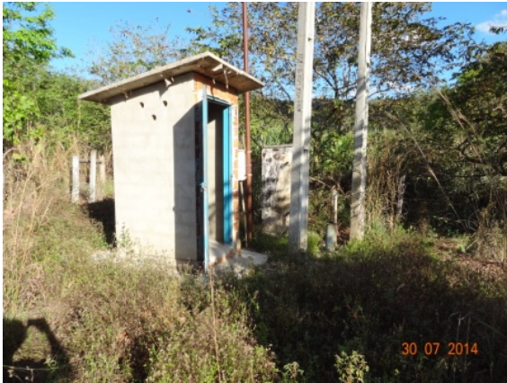
Foto 1 – Área do poço sem identificação
