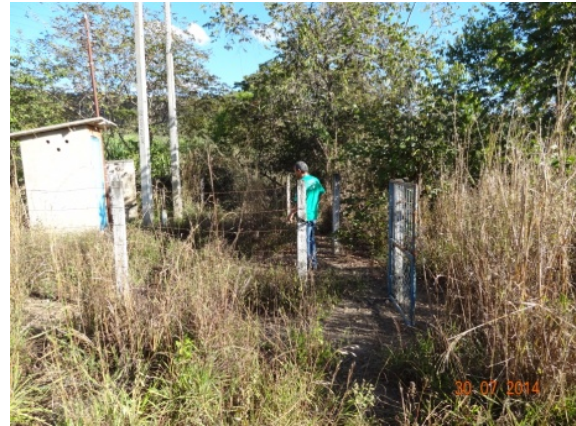
Foto 2 – Falta cadeado e cerca danificada
