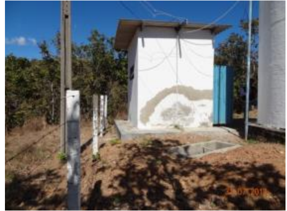
Foto 2 – Perda de revestimento
