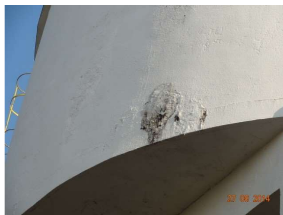
Foto 2 – Trinca e infiltração
