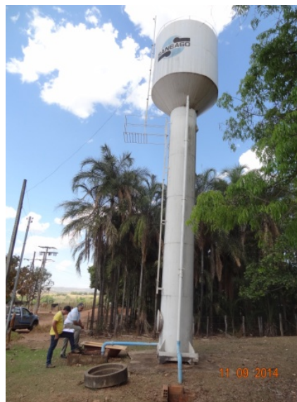
Foto 2 - Ausência de cerca ou muro.
