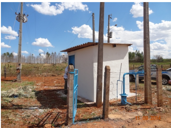
Foto 1 – Inexistência de identificação.
