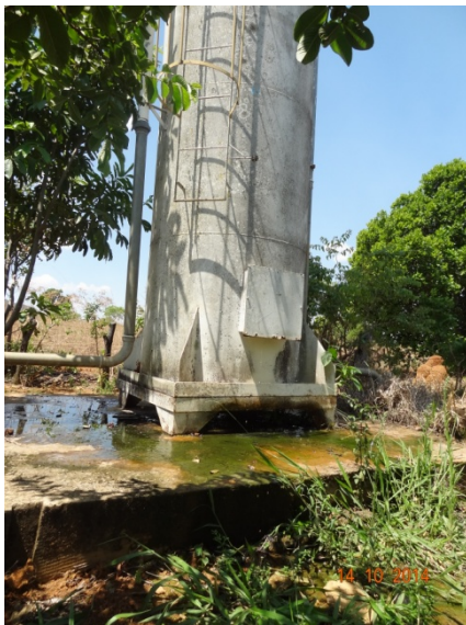
Foto 3 – Presença de vazamento
