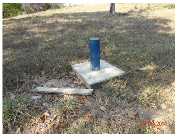
Foto 2 – Poço 02 ainda em não interligado
