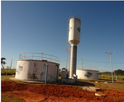
Foto 3 – Res. apoiado pintura desgastada
