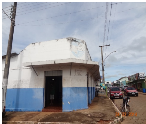
Foto 1 – Escritório pintura desgastada
