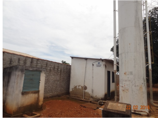
Foto 2 – C.R. São Vicente pinturas desgastadas
