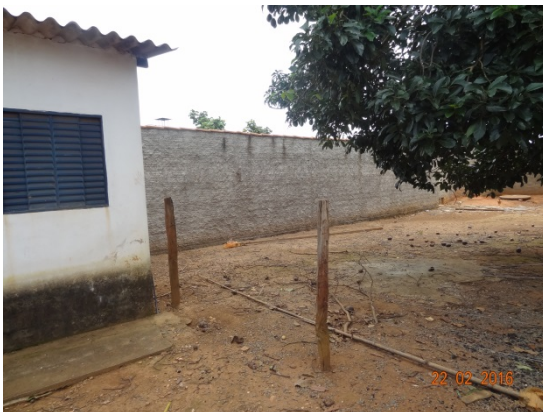
Foto 3 – Falta cerca de proteção na lateral dos fundos
