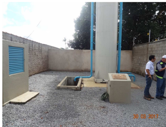
Foto 2 – REL CR São Vicente com cerca e portão recuperados.
