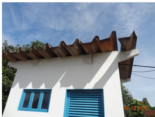
Foto 11 - Reservatório R1 casa de cloração com telhado quebrado
