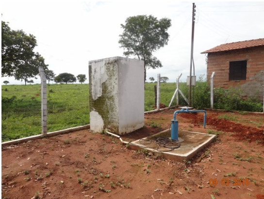
Foto 9 – Poço 04 abrigo com pintura desgastada
