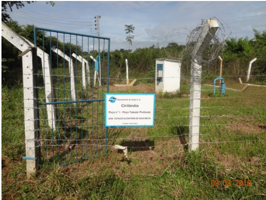
Foto 7 – Poço 01 portão sem cadeado
