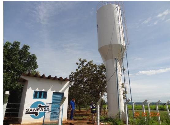
Foto 10 – Reservatório R1 com portão sem cadeado
