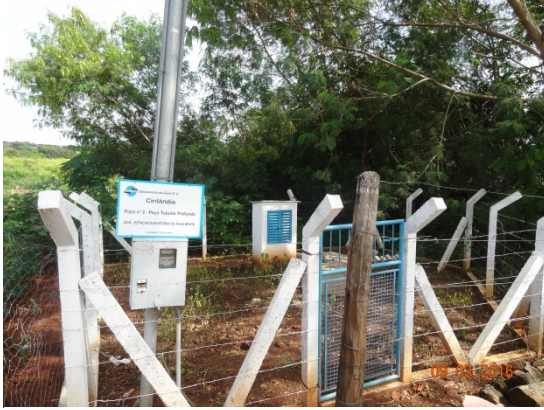
Foto 1 – Poço 02 com cerca
