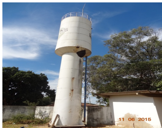
Foto 1 – Presença de corrosão
