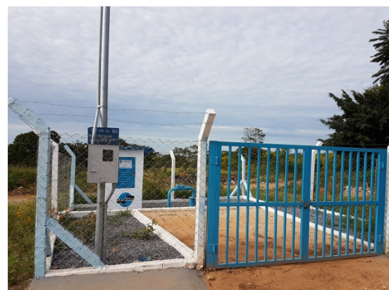
Foto 2 – Poço PMO 04 - Placa identificação instalada
