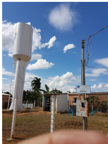
Foto 5 – REL com problema de mato alto e cerca - recuperados
