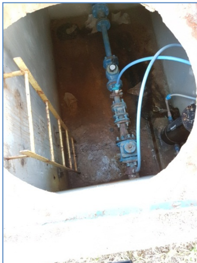
Foto 1 – Vazamento da válvula
