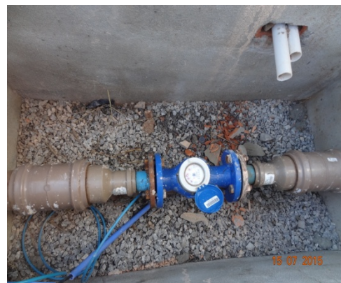
Foto 2 – Res. com macro medidor instalado
