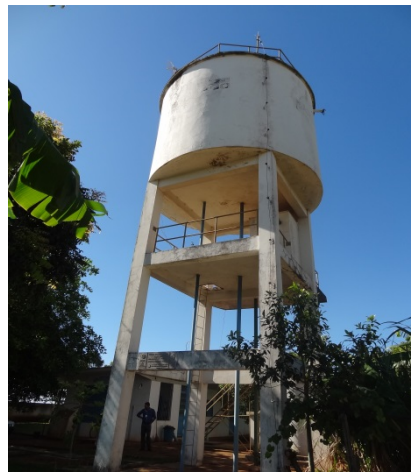
Foto 2 –Pintura desgastada no REL
