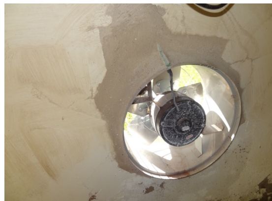
Foto 4 –Sala com exaustor
