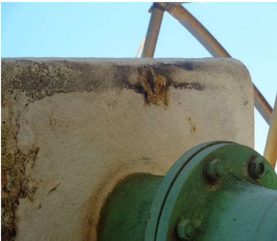
Foto 1 –Vazamento no filtro russo
