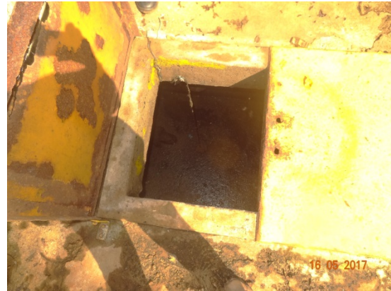
Foto 2 – Tampas de inspeção corroídas
