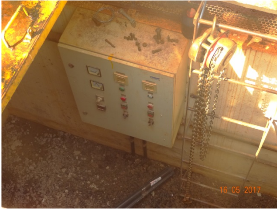
Foto 1 – Quadro de Comando da EEE Vila Operária instalado em fosso
