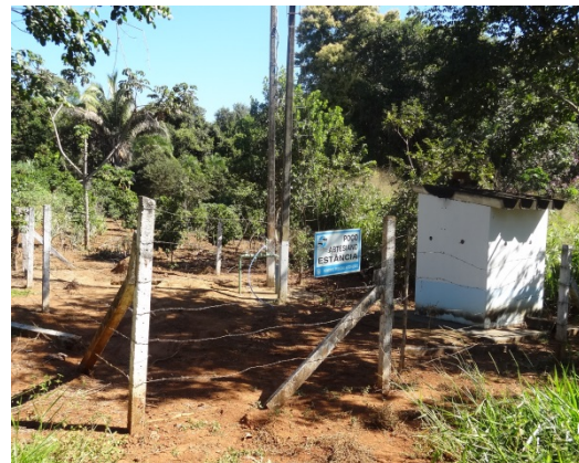
Foto 2 –Poço com identificação
