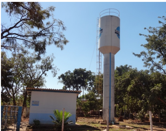
Foto 1 –REL com nova pintura
