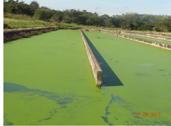
Foto 2 – Excesso de algas na lagoa de maturação
