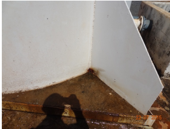
Foto 3 – Furo na base do reservatório – Residencial Boa Esperança
