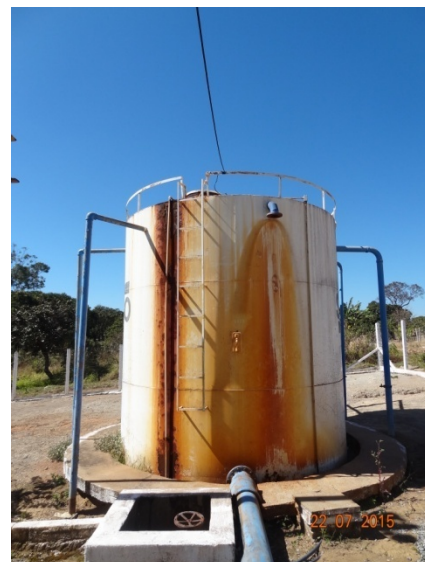
Foto 2 – Corrosão – Caixa de Reunião Jd. Das Paineiras
