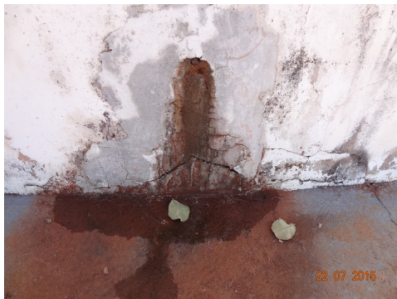
Foto 1 – Infiltração e trinca – Reservatório Itapuã II
