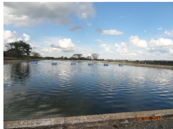
Foto 2 – Aeradores instalados nas lagoas
