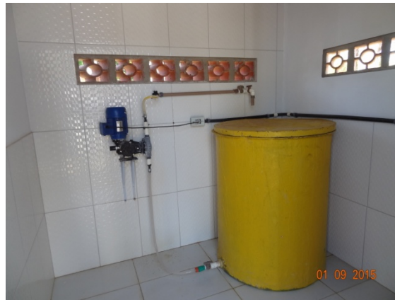
Foto 1 – Processo de pré-cloração para oxidação do ferro e manganês
