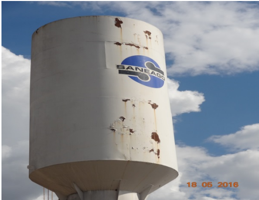
Foto 3 – REL com ferrugem e pintura desgastada.
