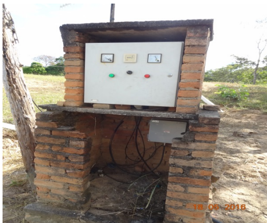
Foto 1 – Ausência de porta, revestimento e presença de fios expostos
