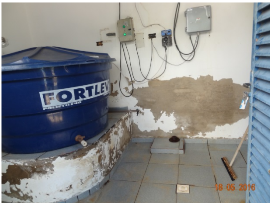
Foto 5 – Abrigo de cloração com perda de revestimento.
