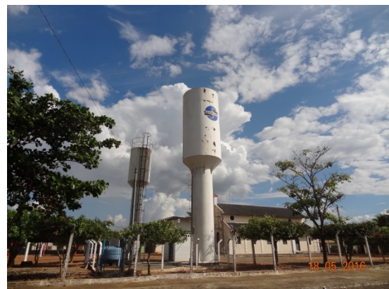
Foto 2 – REL com ferrugem e pintura desgastada.
