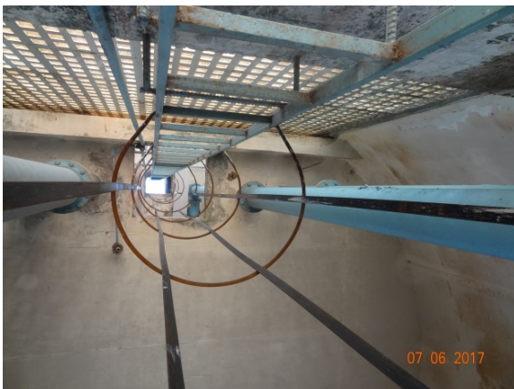
Foto 3 – REL da ETA com guarda-corpos instalados na escada.
