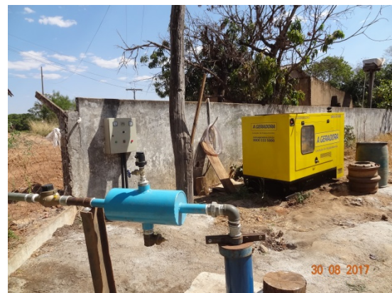
Foto 2 - Poço 307 operado com gerador locado e sem urbanização.
