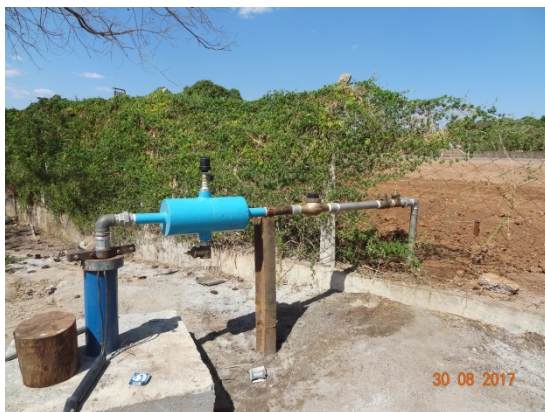
Foto 1 – Poço 307 sem tratamento adequado da água.
