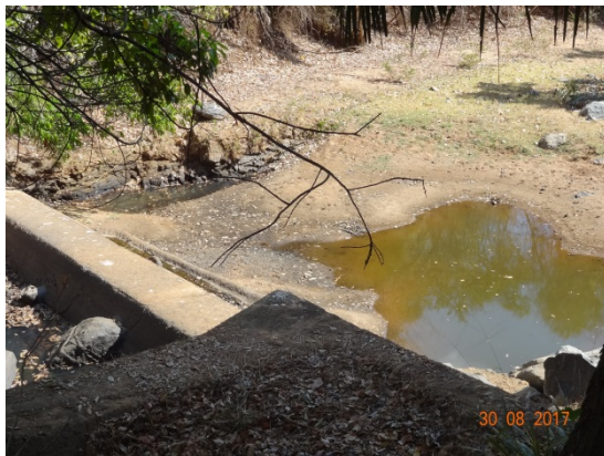
Foto 5 – Captação do Ribeirão Lajeado.
