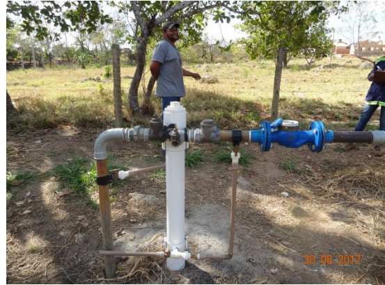
Foto 4 - Poço PGB 180 com tratamento na saída do poço.
