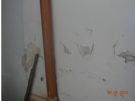
Foto 3 – Pintura desgastada no prédio da ETA.
