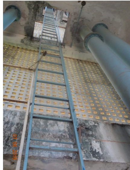
Foto 4 – REL da ETA sem guarda-corpos da escada interna.
