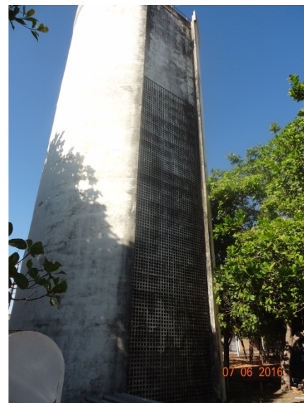
Foto 2 – REL da ETA com pintura desgastada.
