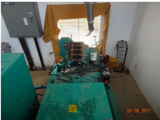
Foto 3 – Gerador da EEE do Setor Oeste Usurpado.
