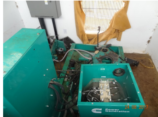
Foto 2 – Gerador da EEE Setor Divinópolis surrupiado.
