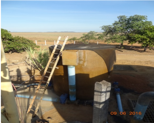
Foto 1 – Filtro russo sem guarda-corpo.
