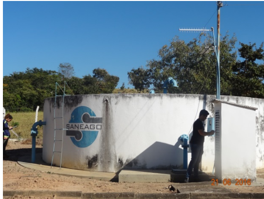
Foto 1 – Reservatório com pintura desgastada
