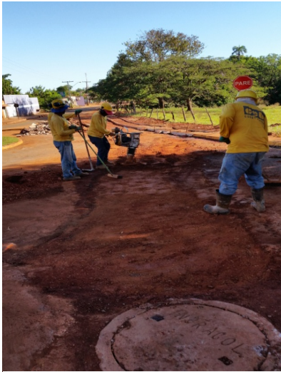
Foto 11 - Rede coletora Vila Palmeira
