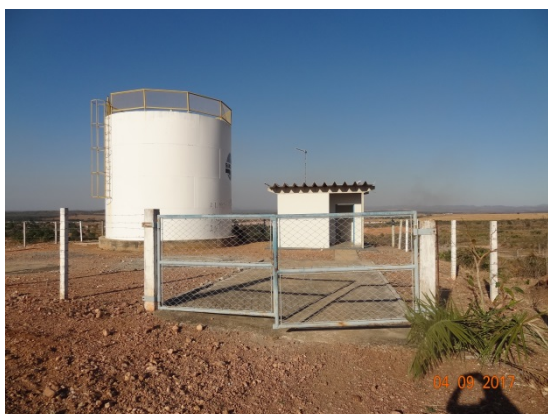
Foto 1 – RAP metálico 200m 3 sem placa de identificação.
