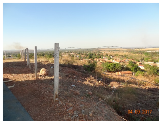
Foto 2 – RAP metálico 200m 3 com cerca danificada.
