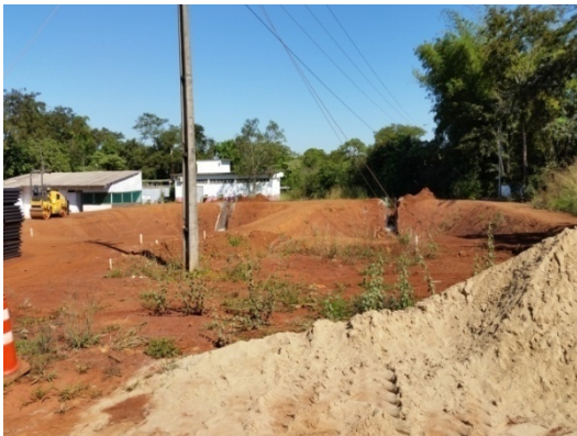
Foto 7 - Lagoas de Sedimentação
