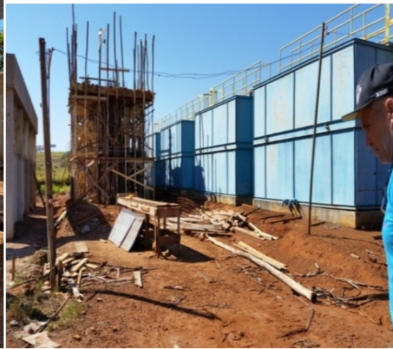
Foto 6 - Calha Parshall / ETA Compacta
