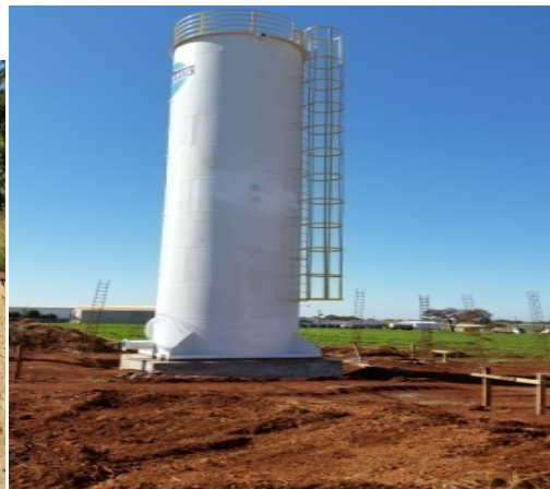
Foto 8 - Tanque de Equilíbrio
