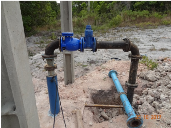
Foto 1 – Poço 02 interligado à ETA
