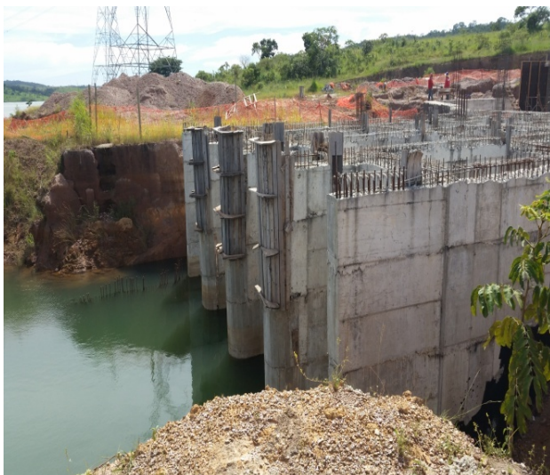
Foto 7 - Entrada água para bombas na EEAB Corumbá-31/03 e 1º/04
