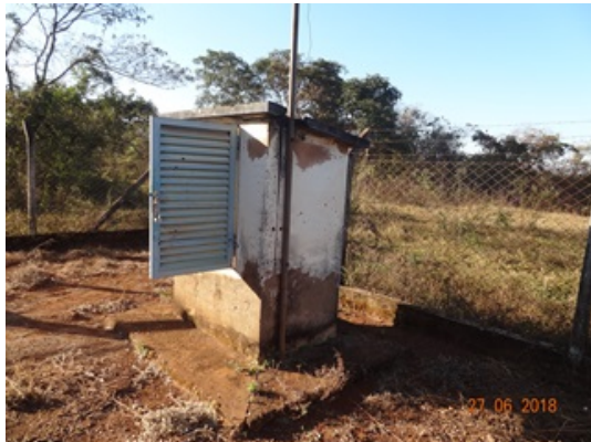
Foto 3 - Quadro de comando com pintura desgastada
