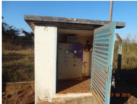
Foto 2 - Quadro de comando com pintura desgastada
