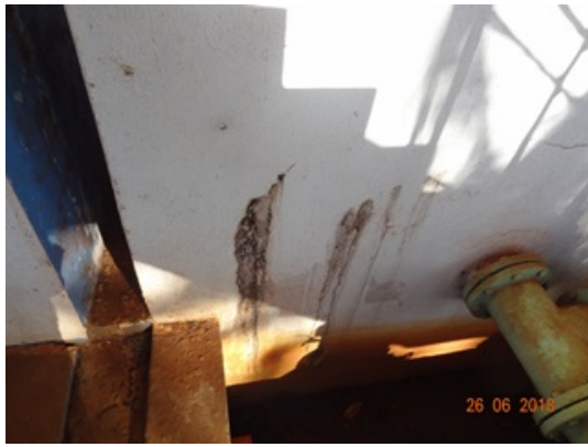
Foto 3 - ETA com infiltrações e eflorescências na galeria dos filtros.
