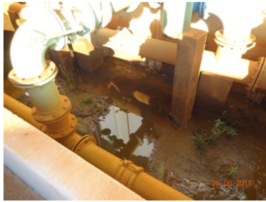
Foto 4 - ETA com vazamentos nos registros dos filtros.
