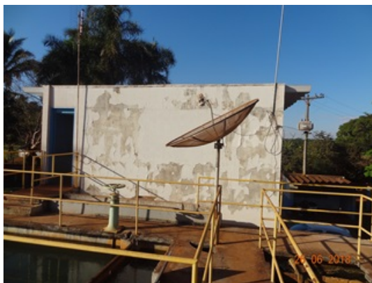
Foto 1 - ETA com pintura desgastada das edificações.
