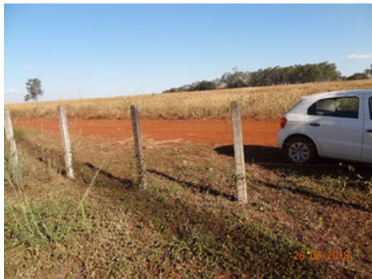
Foto 9 - REL/Nossa Senhora da Guia com cerca de proteção danificada.
