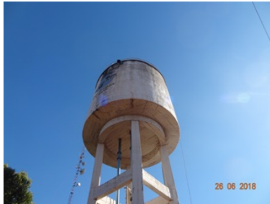
Foto 7 - C.R./Maurilândia com pintura desgastada.
