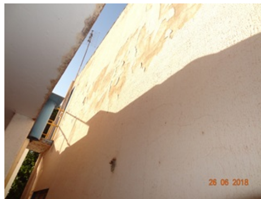
Foto 2 - ETA - Floco-decantadores e decantadores com infiltrações e eflorescências.
