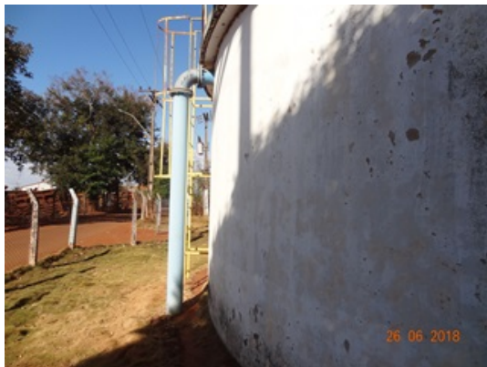
Foto 8 - C.R./Maurilândia com pintura desgastada.
