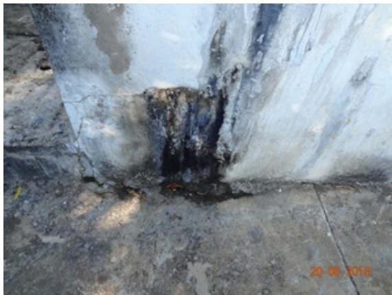
Foto 3 - Presença de infiltrações, eflorescências e mofo.
