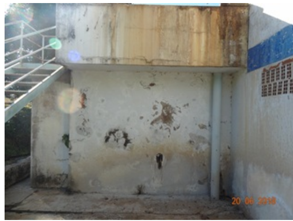
Foto 2 - Parede externa do floculador com infiltrações e pintura desgastada.
