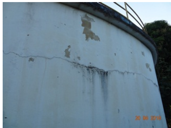
Foto 6 - Presença de trincas e pintura desgastada no reservatório
