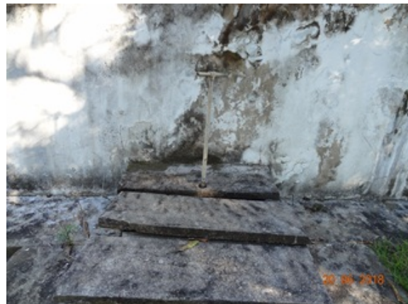
Foto 4 - Decantadores com presença de infiltrações, eflorescências e mofo.
