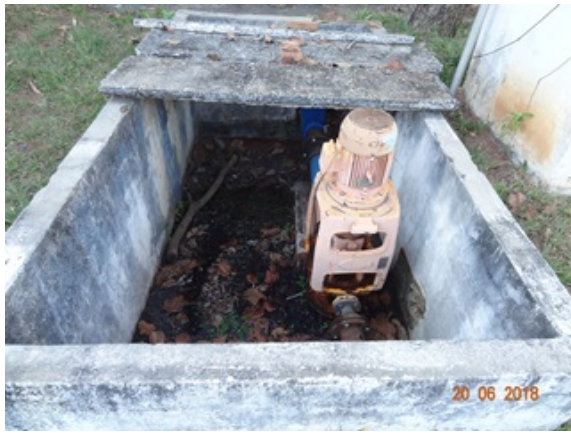
Foto 7 - Vazamento nas gaxetas.
