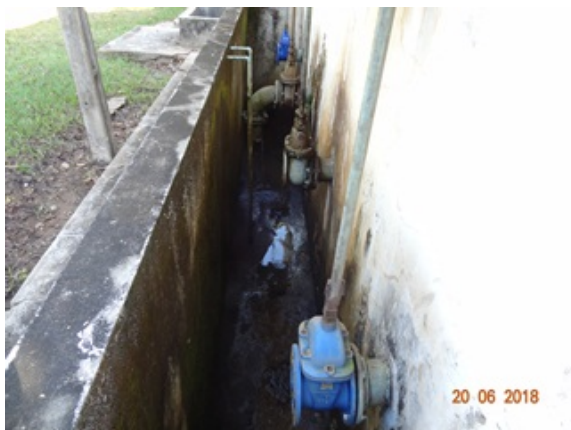
Foto 5 - Vazamentos registros dos filtros.
