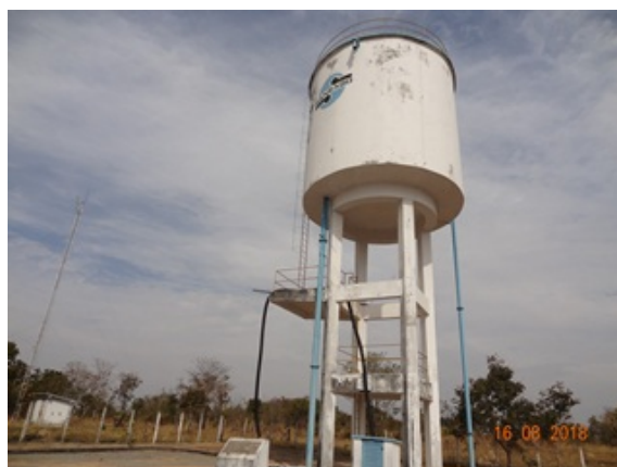
Foto 4 - Pintura desgastada REL St. Planalto
