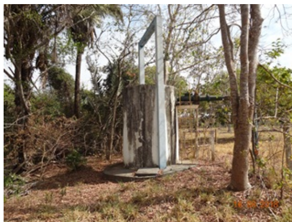
Foto 8 -Pintura desgastada Poço Sucção Captação/EEAB.
