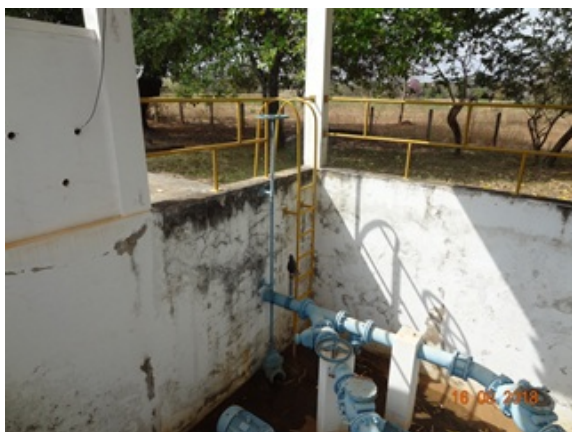
Foto 7 Falta guarda-corpo escada na EEAT/ETA.
