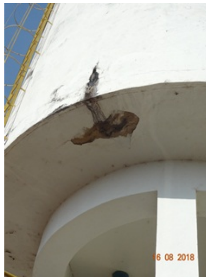
Foto 6 - Perda de revestimento REL/Centro.
