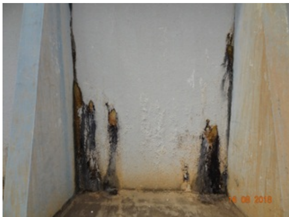
Foto 1 - Presença de infiltrações e eflorescências.
