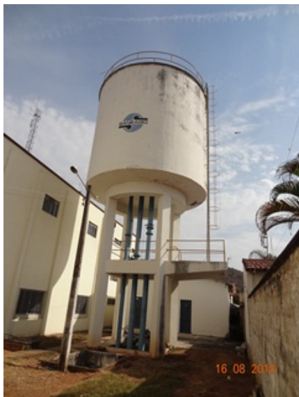
Foto 5 - Pintura desgastada REL/Centro.
