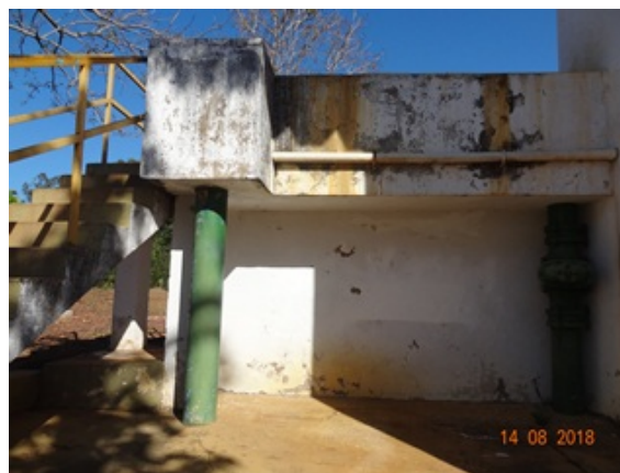
Foto 4 - ETA 02 Pintura desgastada.
