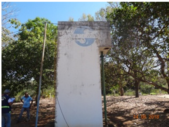
Foto 7 - Ausência de guarda-corpos.
