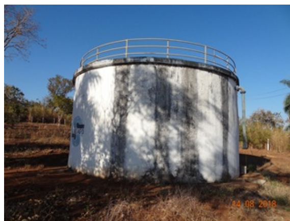
Foto 12 - RAP pintura desgastada.
