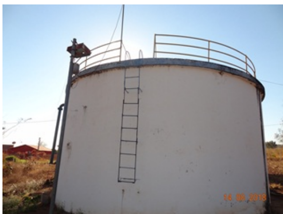
Foto 11 - Ausência de guarda-corpo.
