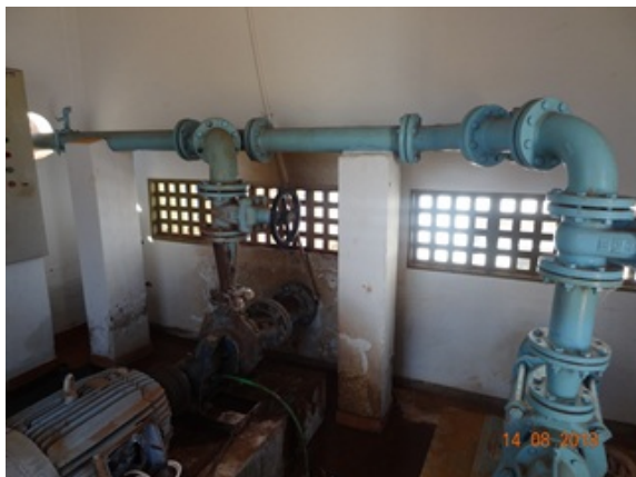
Foto 1 - Vazamento nas gaxetas.
