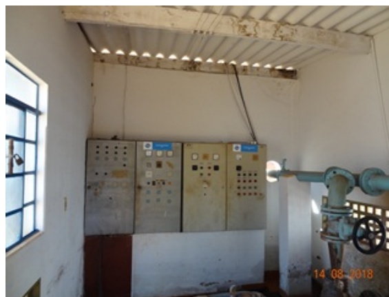
Foto 6 - Falta aviso de risco.
