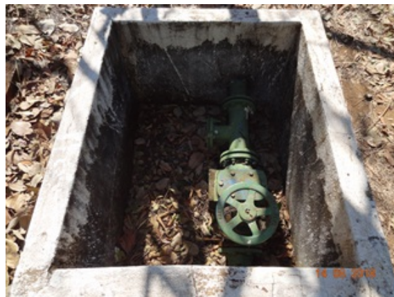
Foto 8 - Caixas de manobra sem tampas de proteção ou guarda corpo.
