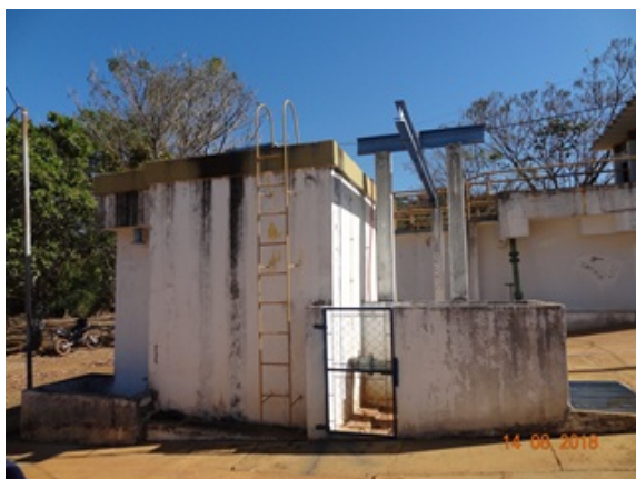
Foto 5 - Ausência de guarda-corpos.
