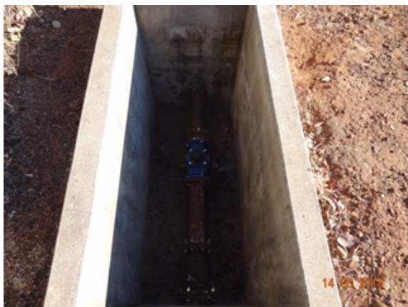
Foto 09 - Caixa de passagem sem tampas de proteção ou guarda corpo.
