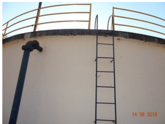
Foto 10 - Ausência de guarda-corpo.
