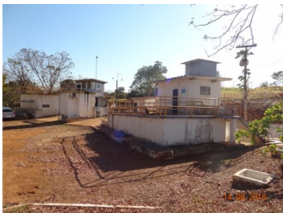
Foto 3 - ETA 01 pintura desgastada.
