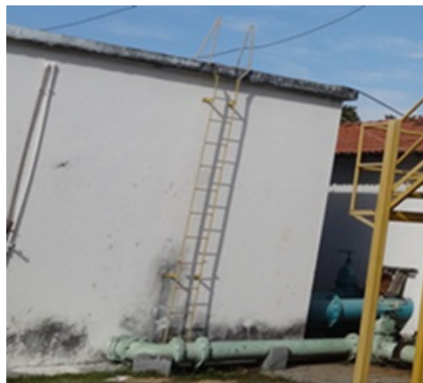
Foto 2 - Falta guarda-corpo - escada de acesso e topo.
