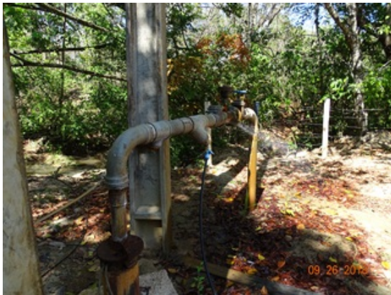
Foto 9 - Vazamento carritel do cavalete.
