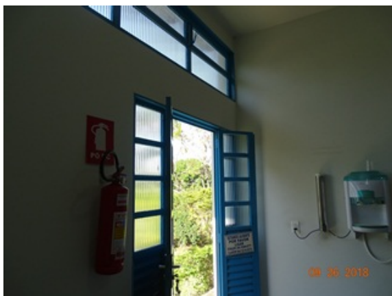
Foto 1 - Falta identificação de bebedouro.
