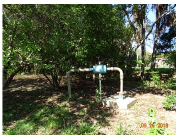
Foto 6 - Poço sem identificação e sem cerca de proteção.
