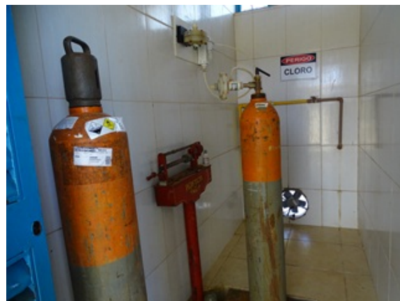
Foto 2 - Exaustor não funcional ("queimado").
