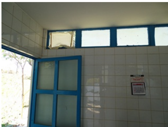
Foto 1 - Vidros quebrados laboratório.
