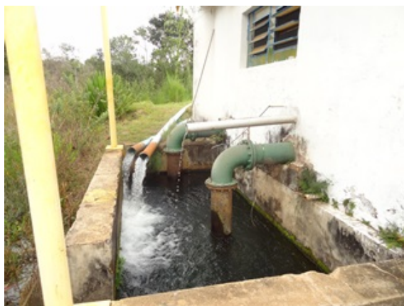
Foto 6 - Água dos poços P10 e P11 sendo lançada na captação superficial.
