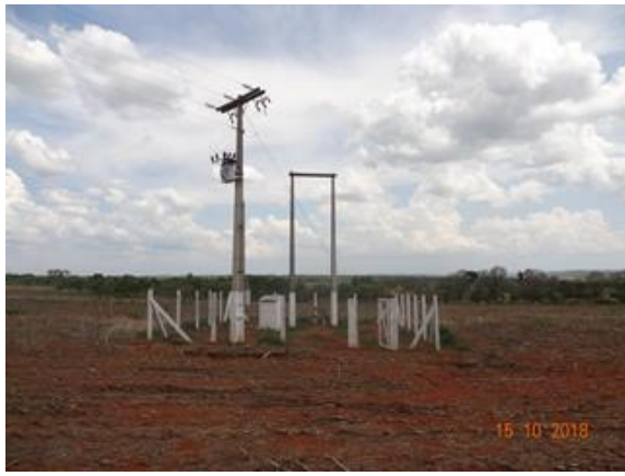
Foto 3 - Ausência de identificação no Poço 04
