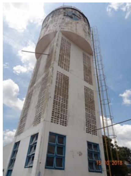
Foto 2 - Pintura desgastada no REL 01 - CR
