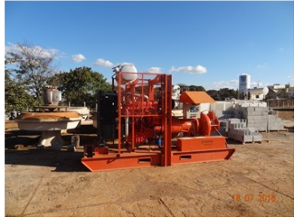
Foto 2 - Grupo gerador móvel a ser utilizado na reversão da captação do Rio Capivari até a EEAB do Rio Piancó II.
