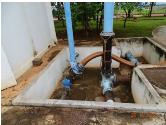
Foto 5 - Caixa de passagem sem tampa ou grade de proteção.
