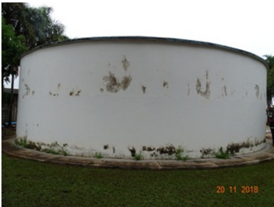
Foto 10 - Pintura desgastada RAP/CR.
