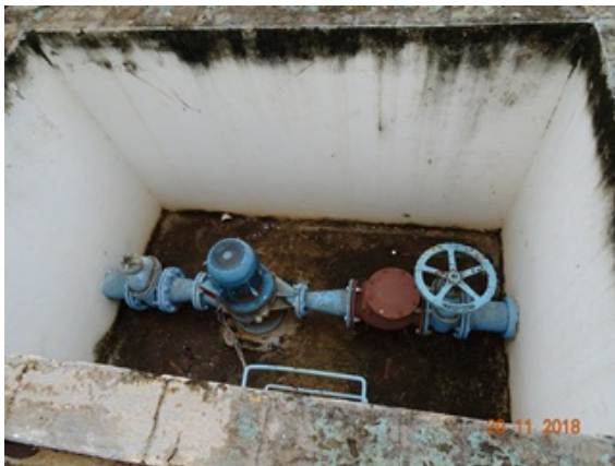
Foto 3 - Caixa de passagem sem tampa ou grade de proteção.
