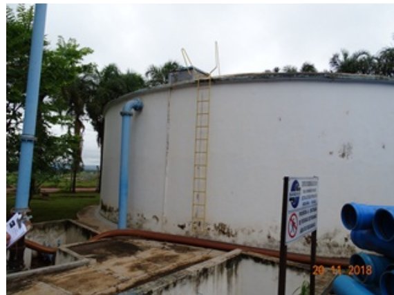
Foto 11 - Ausência de guarda-corpo na escada e topo do reservatório.
