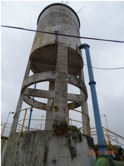
Foto 8 - Pintura desgastada do REL/ETA
