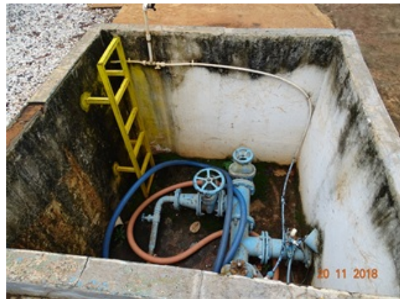
Foto 4 - Caixa de passagem sem tampa ou grade de proteção.
