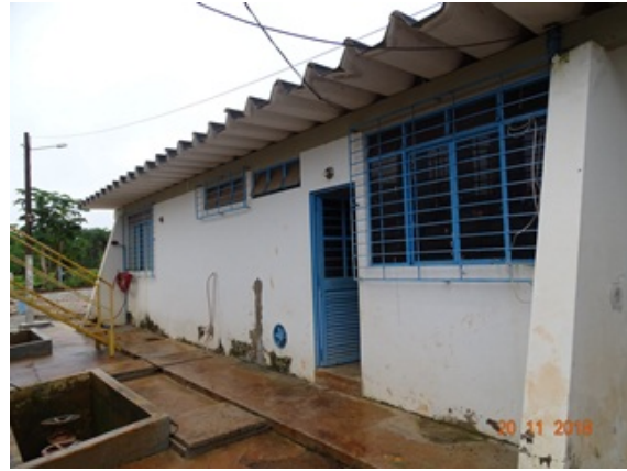
Foto 2 - Pintura desgastada edificações da ETA.
