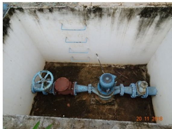
Foto 6 - Caixa de passagem sem tampa ou grade de proteção.
