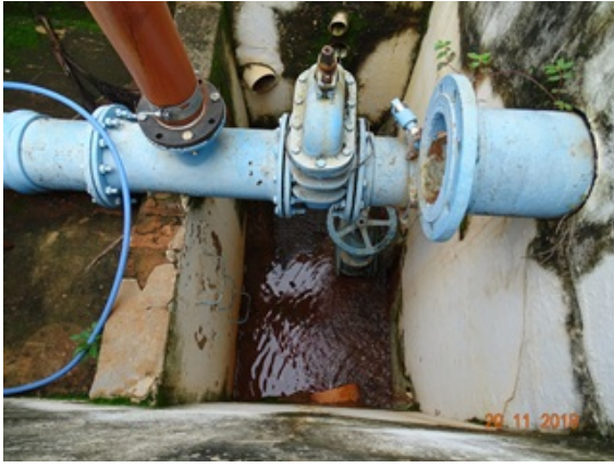
Foto 7 - azamento na base do reservatório apoiado
