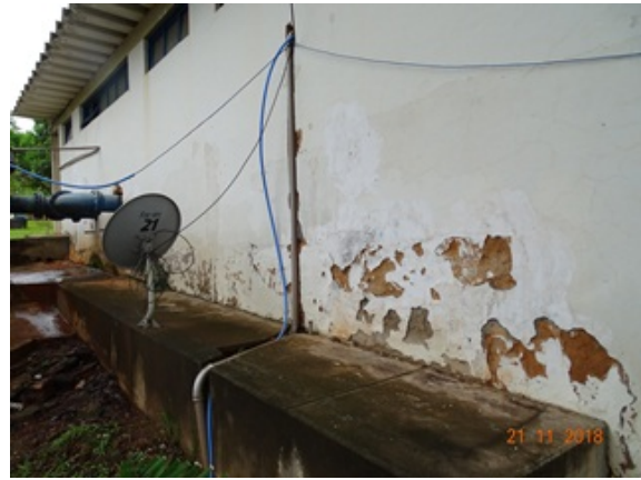
Foto 4 - Edificação da ETA com pintura desgastada e perda de revestimento.
