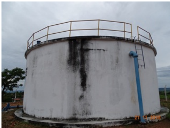
Foto 7 - Pintura desgastada do RAP/CR
