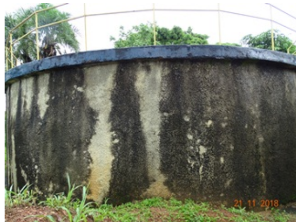
Foto 6 - Pintura desgastada RSE/ETA.
