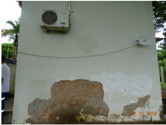
Foto 3 - Edificação da ETA com Pintura desgastada e perda de revestimento.
