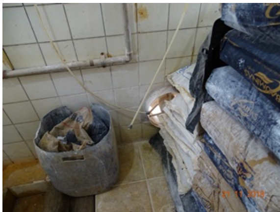
Foto 5 - Sacos de cal obstruindo o exaustor na sala de cloração.
