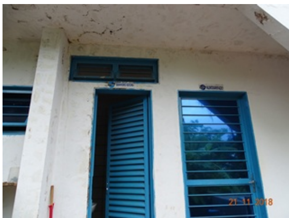
Foto 1 - Pintura da edificação do distrito/comercial desgastada.
