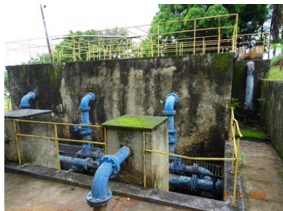
Foto 2 - Edificações da ETA com Pintura desgastada.
