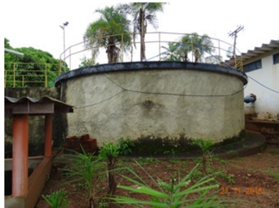
Foto 8 - Pintura desgastada RSE/ETA .
