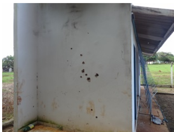
Foto 4 - EEE/Bairro Martins com edificações danificadas
