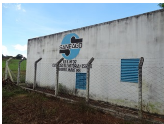
Foto 3 - EEE/Bairro Martins com pintura desgastada
