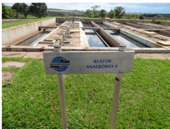
Foto 1 - Ausência de guarda-corpo nos reatores
