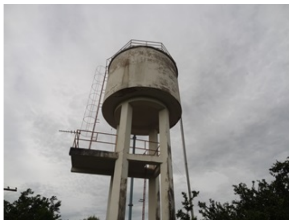
Foto 4 - REL da ETA com pintura desgastada.
