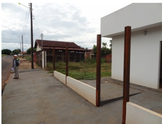
Foto 7 - Ausência de cerca e portão de segurança no poço.
