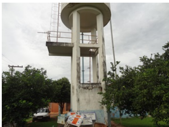
Foto 5 - REL da ETA sem guarda-corpos na escada de acesso até a plataforma.
