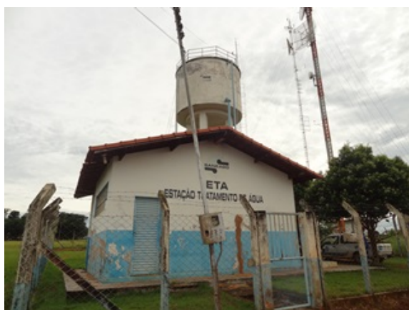
Foto 1 - ETA com pintura desgastada e perda de revestimento.
